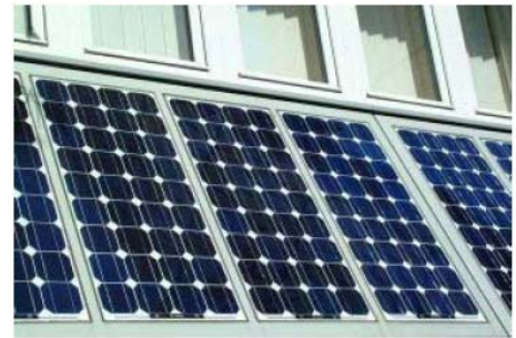
5. Солнечные батареи как часть фасада дома. © Freefoto.com.
