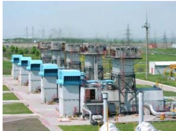
6. Verdichter und Turbinen an der Kompressorstation Kursk © LA
