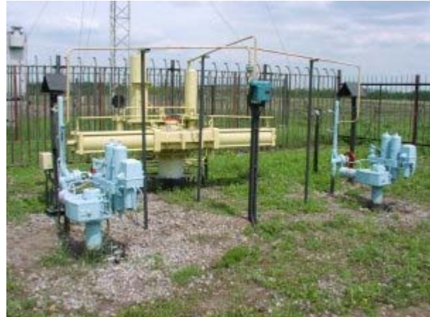
4. Ventilknoten der Gasleitungen in der Nähe der Stadt Kursk. Die Leitungen selbst liegen unterirdisch.
