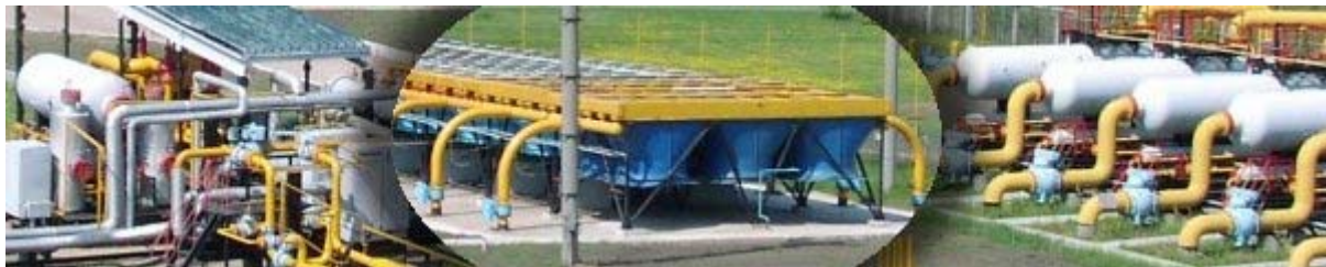
7. Gaskühler, Gastrockner und Brenngas-Versorgung an der Kompressorstation Kursk © LA
