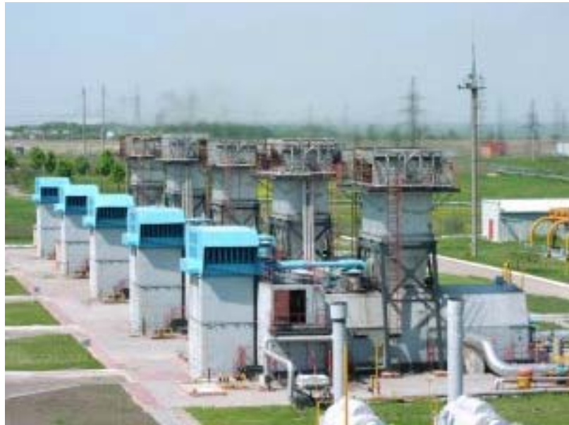
5. Compresseurs et turbines à la station de compression de Kursk © LA
