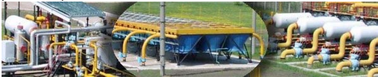
6. Machines servant à refroidir et sécher le gaz, et système d'approvisionnement en gaz combustible à la station de compression de Kursk. © LA
