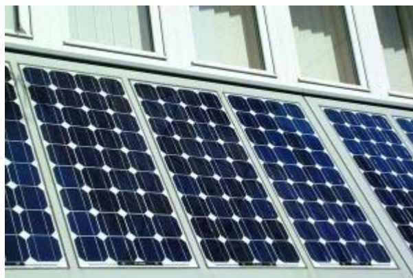
5. Cellules photovoltaïques sur le mur d'une maison © Freefoto.com
