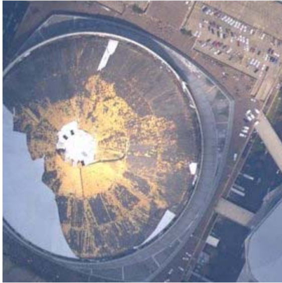
6. Das Dach des Louisiana Superdome wurde durch den Hurrikan Katrina am 29. Aug 2005 stark beschädigt.
